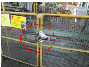
ベルトコンベアの防護柵の扉に取り付けた鍵 (インターロック付き)
