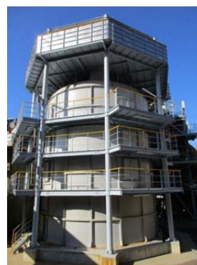
FRP製 硫酸吸収塔（改良後）
