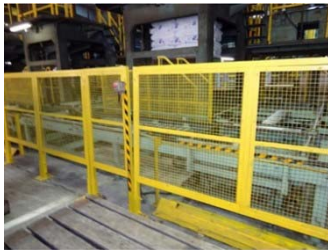
ロールコンベアの防護柵
